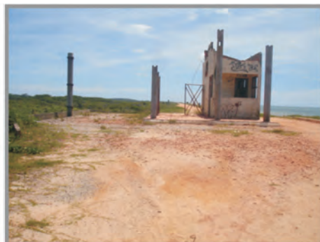
(b) Roubo da estrutura física do Portal de entrada, jul. 2009 Foto: Francisco de Assis Esteves
